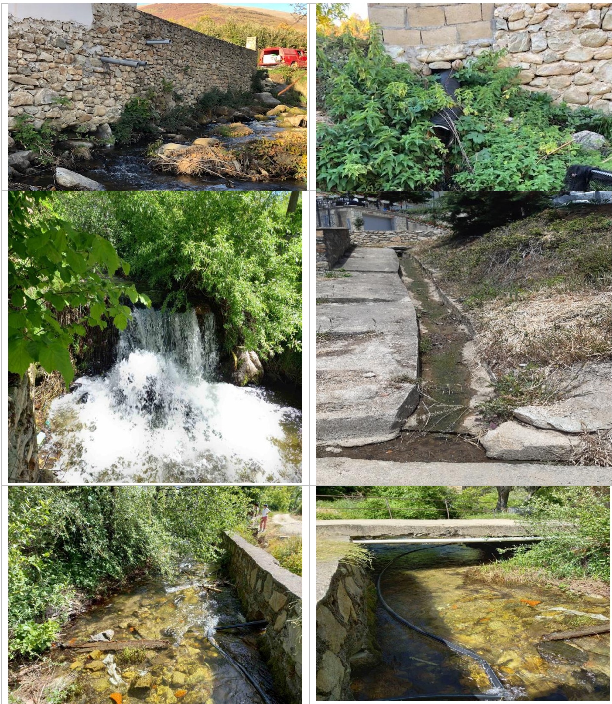
Слика 55-56. Одводни канализациски цевки кои се излеваат директно во Кранска Река; мини брана од 1,8 метри; зафаќање и континуиран истек на водата од реката поради отсуство на канализациска инфраструктура во селото Арвати
